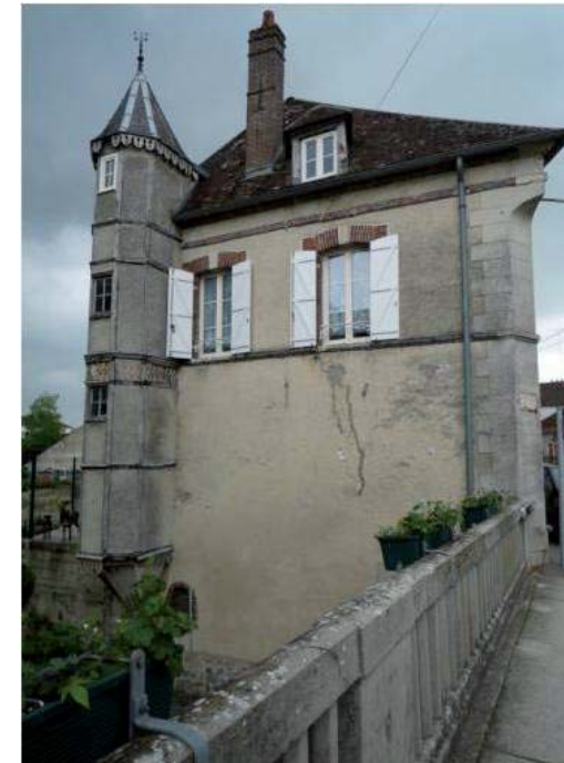
Mauvais état par manque d'entretien
