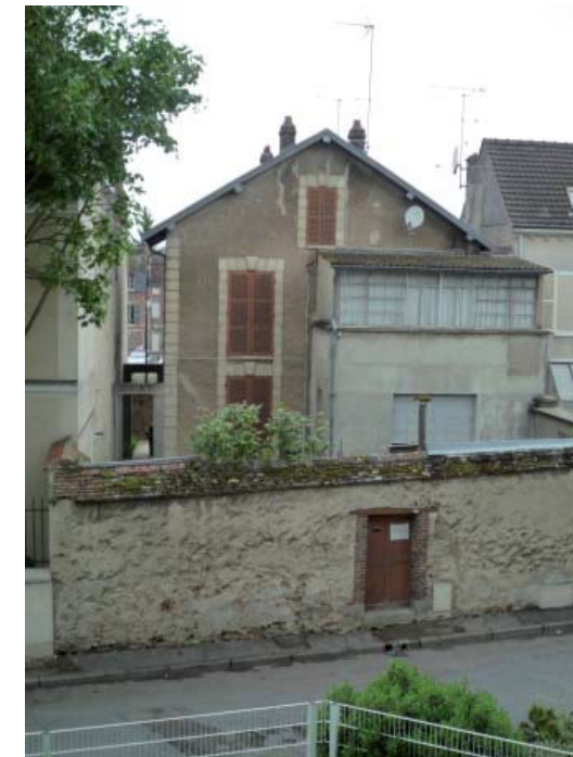
Dénaturations par des adjonctions
