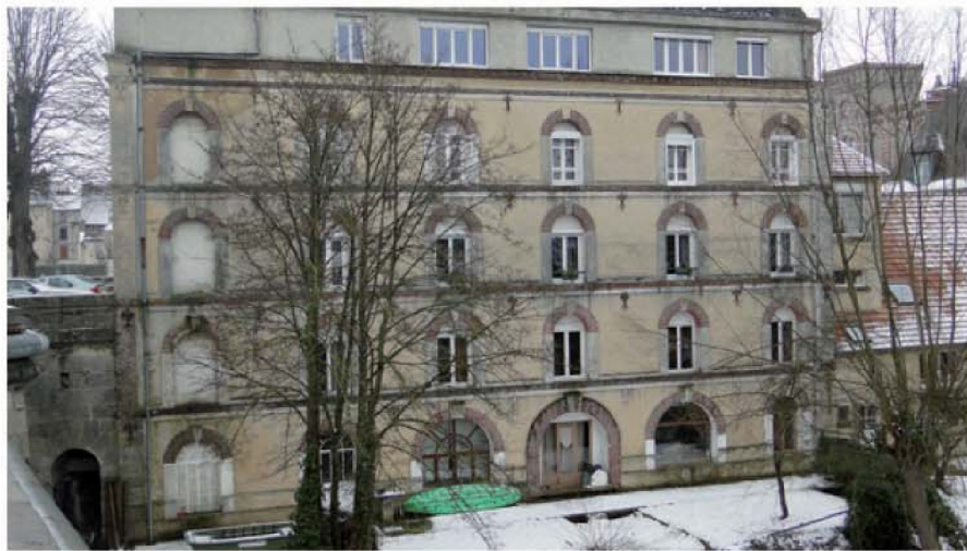
Bâtiment dénaturé par la surélévation d'un étage, l'obturation de plusieurs baies et le remplacement des menuiseries (les nouvelles ne tiennent pas compte de la forme en plein cintre des fenêtres).
