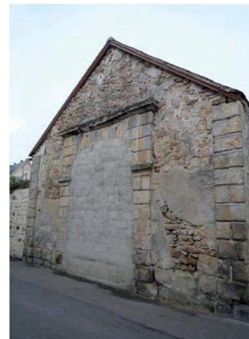
Mauvais état et dénaturation patrimoniale (ancienne chapelle Saint-Vinebaud)
