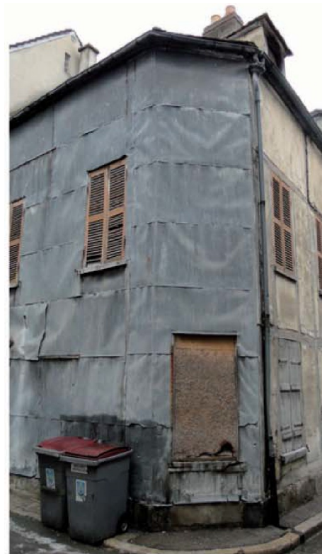
Maison en pan de bois dénaturée par un bardage métallique, une baie grossièrement murée et une descente d'eau pluviale en mauvais état.
