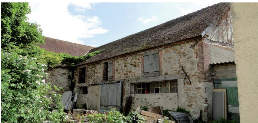
Vacance des locaux d'entreposage et anciens silos à l'état de semi-abandon
