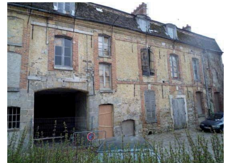
Mauvais état par abandon
